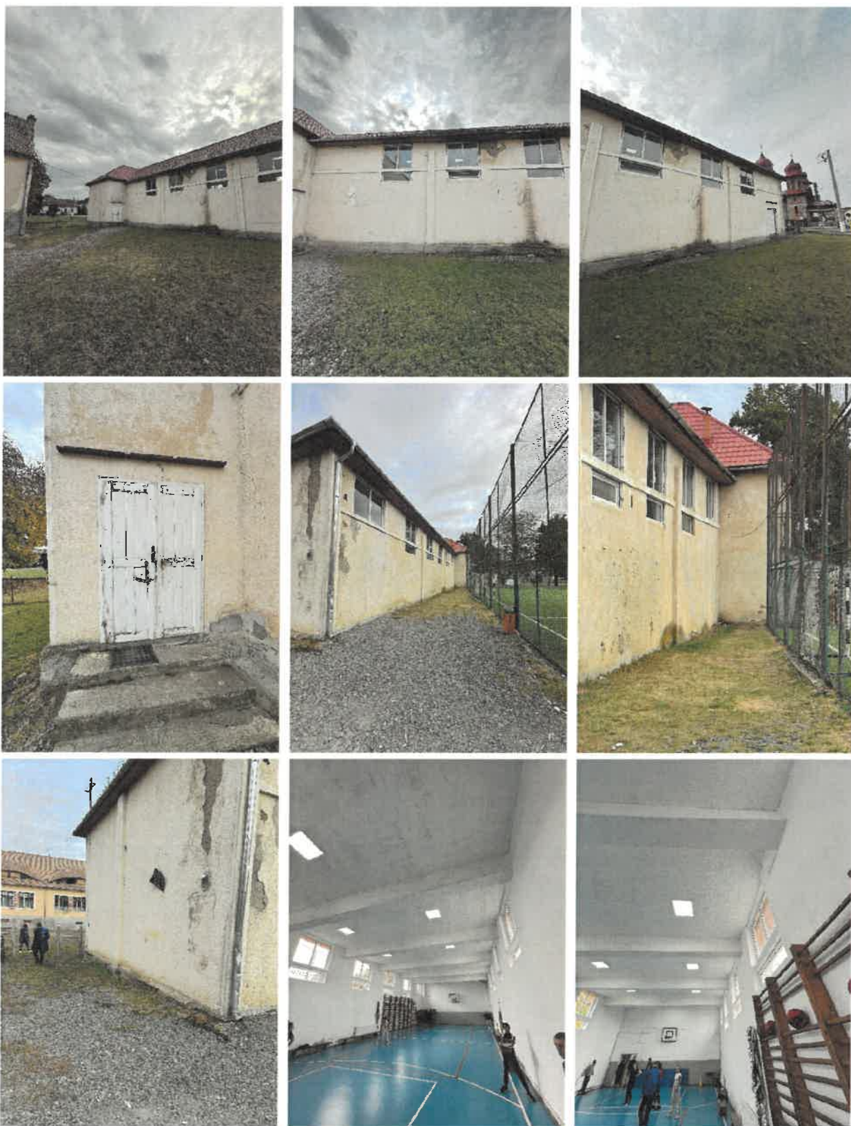
Corp C2 – sala de sport, imagini de la exterior si interior. Avem o uzura pronuntata a finisajelor datorita lipsei protectiilor (trotoare, sistematizare teren, jgheaburi si burlane bine intretinute si canalizate).
